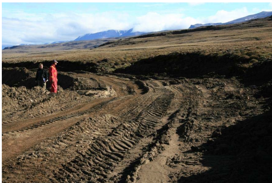
Figur 21. Opgivet kørespor (km 19,9), 28. august 2007. Sporet blev for blødt pga. optøet permafrost, og det blev forlagt til flodsengen.
