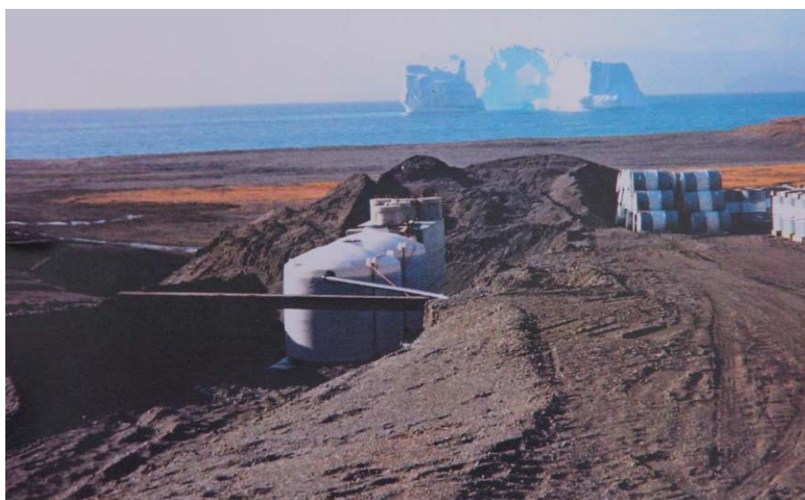
Figur 6. Kloaksystemet ved base camp, sommer 1996. Der blev arbejdet meget i terrænet i dette område. Foto fra Well History Report (grønArctic 1996).
