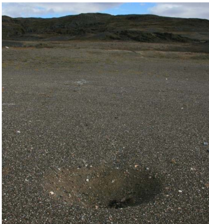
Figur 11. Ny indsynkning, vest for brønden, 23. august 2007.
