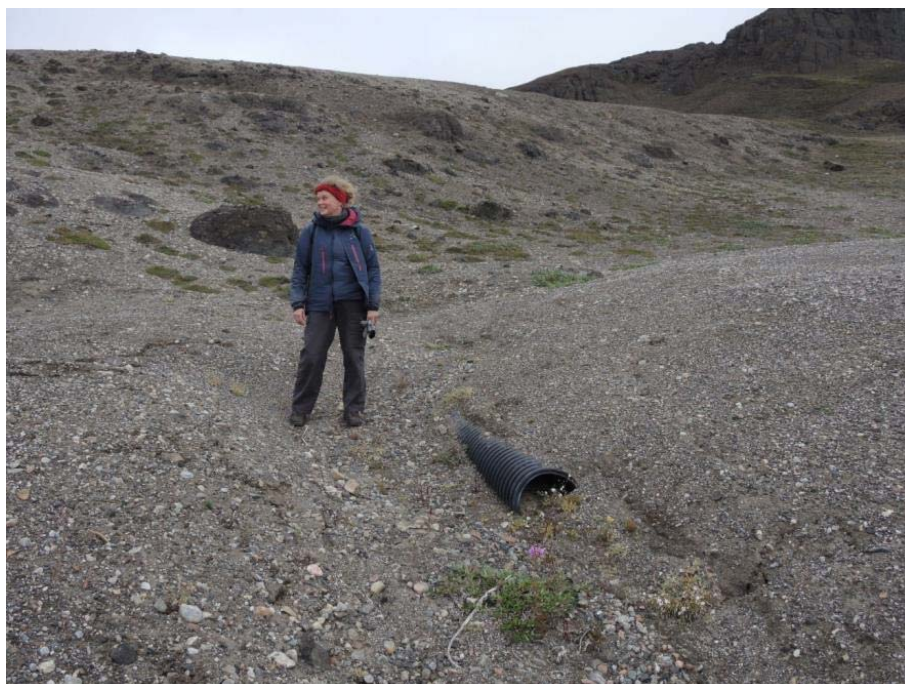
Figur 29. Et enkelt sted på den undersøgte strækning lå der stadig et underføringsrør.
